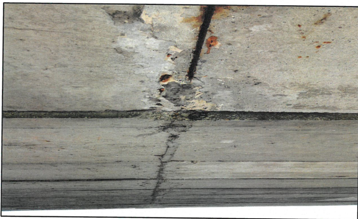
Foto nr. 2 – Beton degradat in rosturile transversale intre tronsoanele prefabricate
