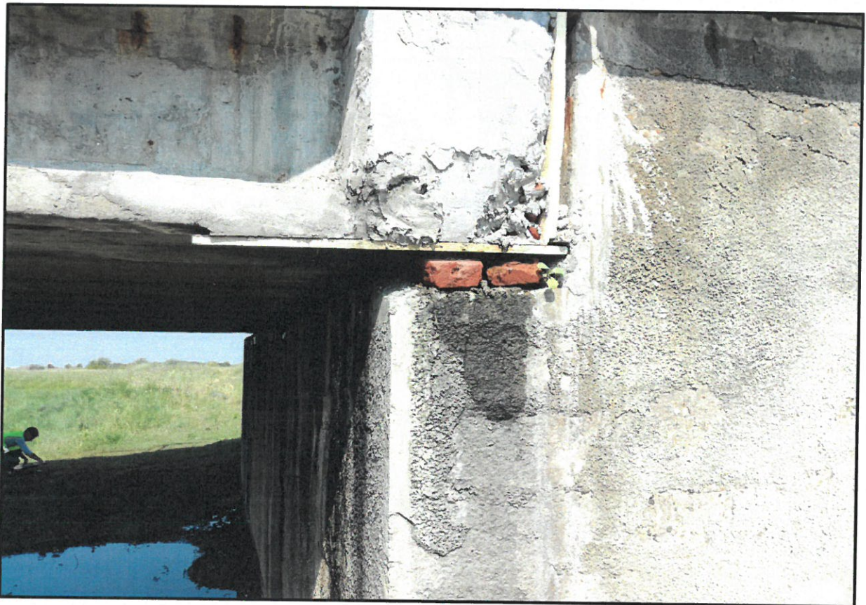
Foto nr. 6 – Blocarea deplasării in zona rostului de dilatație
