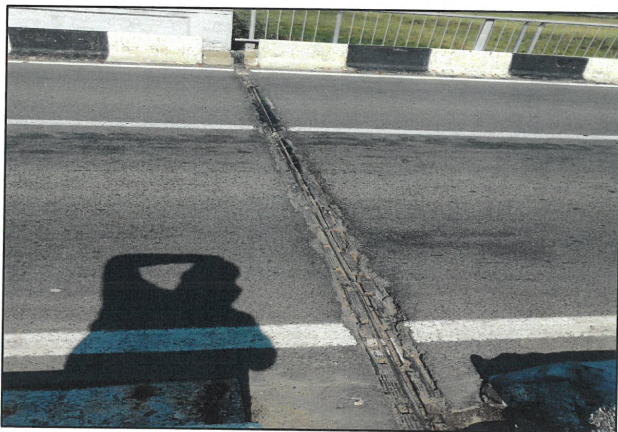
Foto nr. 8 – Degradarea dispozitivului de acoperire a rosturilor de dilatație
