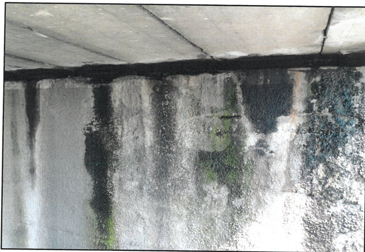
Foto nr. 7 – Infiltrații prin dispozitivul de acoperire, infiltrații pe bancheta de rezervare
