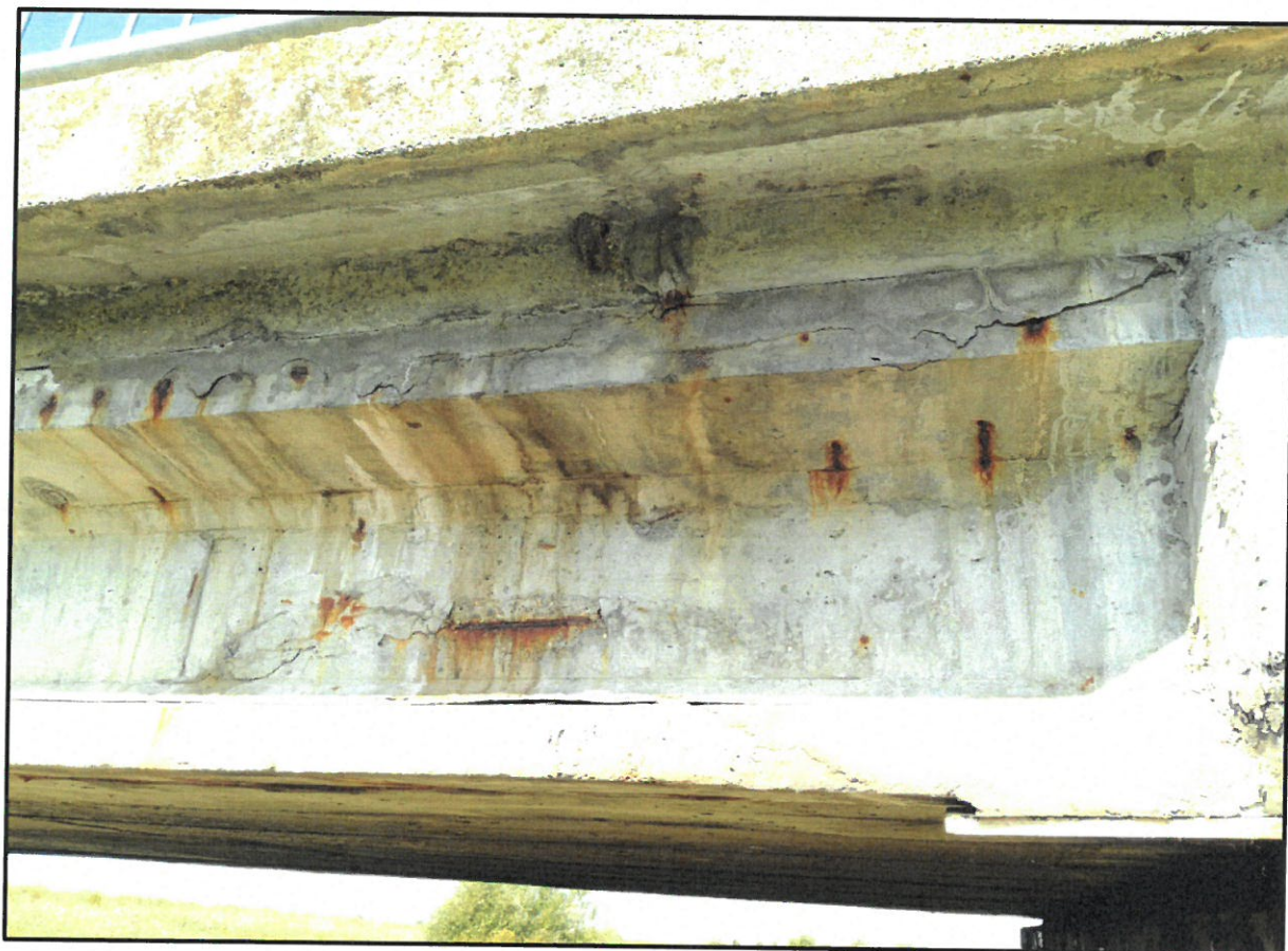
Foto nr. 3 – Fisuri si crăpături in inima grinzilor marginale
