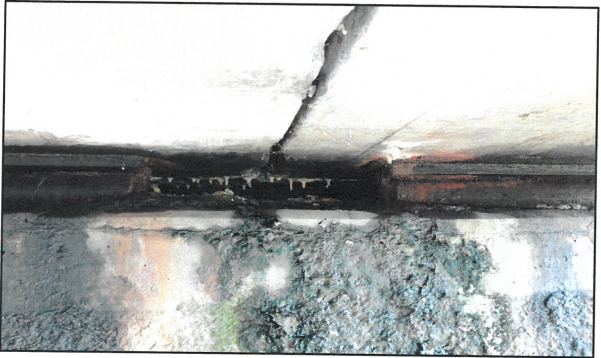
Foto nr. 5 – Coroziunea avansata a aparatelor de reazem metalice
