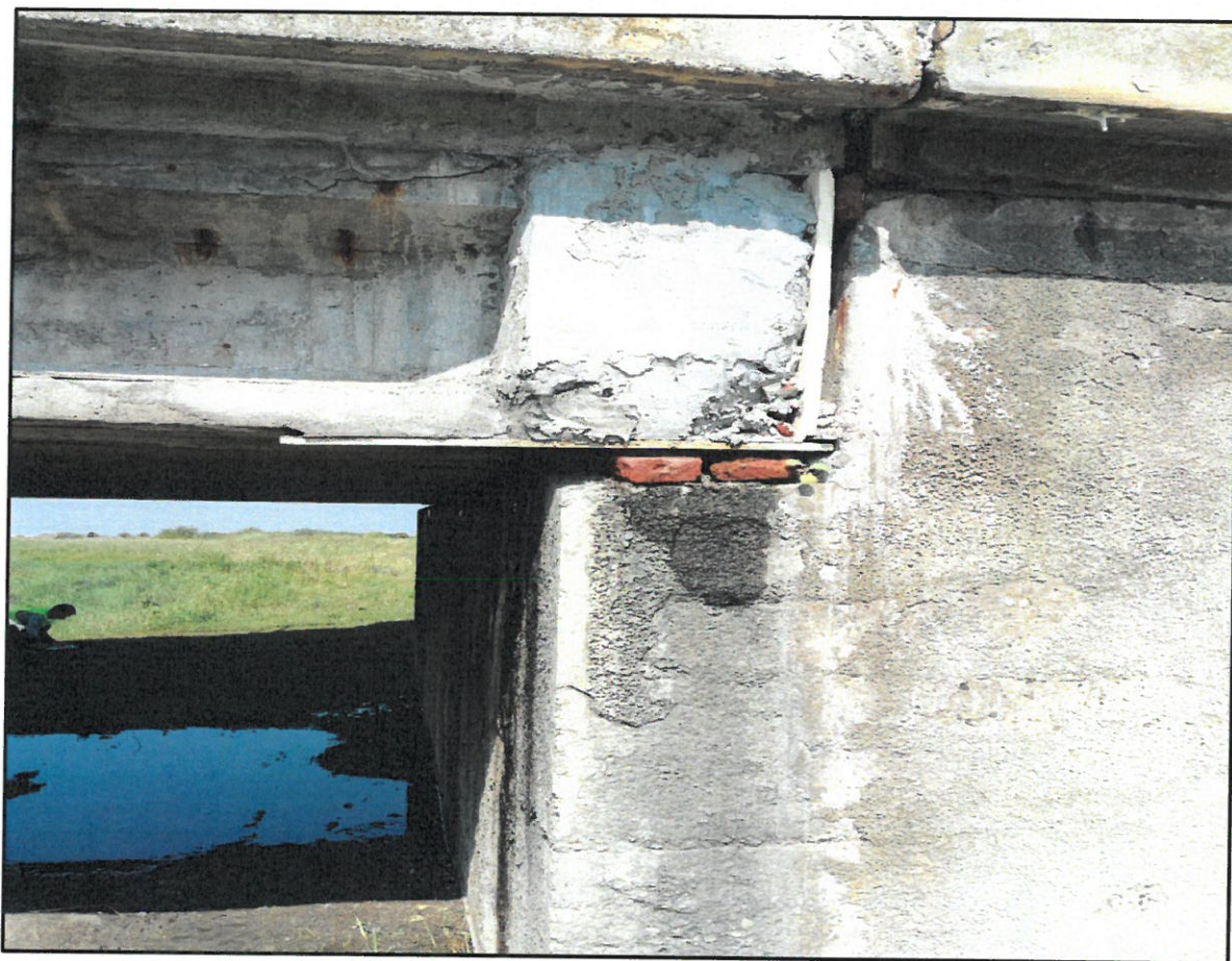
Foto nr. 1 – Degradarea betonului in zona de capăt a grinzilor principale
